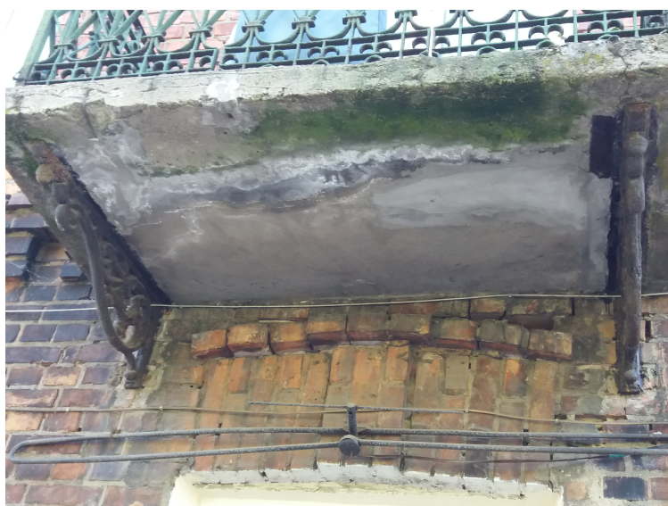
Zdjęcie nr 3: Widok balkonu, widoczne uszkodzenia płyty balkonowej, ślady zawilgocenia i przemarzania oraz korozja konstrukcyjnych elementów stalowych
