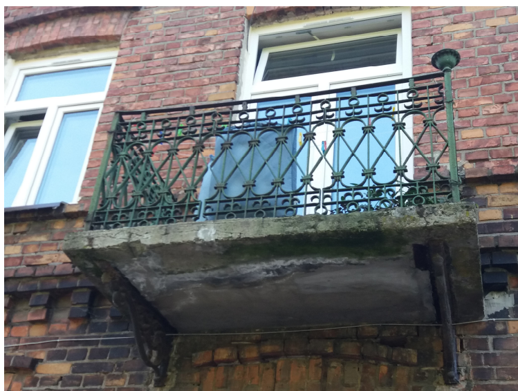
Zdjęcie nr 2: Widok balkonu, widoczne uszkodzenia płyty balkonowej, ślady zawilgocenia i przemarzania oraz korozja konstrukcyjnych elementów stalowych
