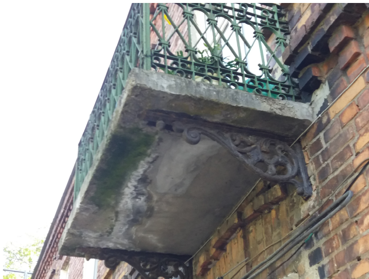
Zdjęcie nr 4: Widok balkonu, widoczne uszkodzenia płyty balkonowej, ślady zawilgocenia i przemarzania oraz korozja konstrukcyjnych elementów stalowych
